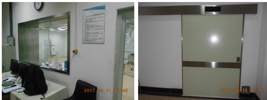
图 4.2-1 机房控制室报警设备和防护门
